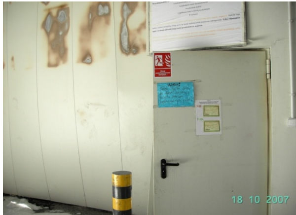
Rysunek 1 – Strona zabezpieczona bramą MARC-P - widok po pożarze po stronie przeciwnej do ognia
